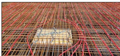
Decke mit Betonkerntemperierung
